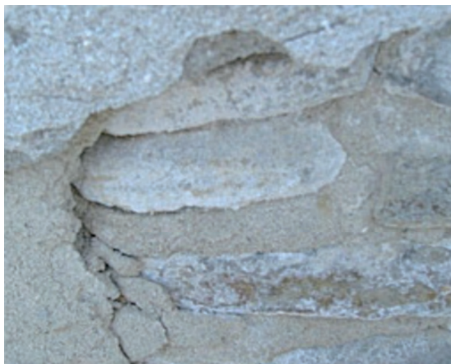
Muro in sassi con efflorescenze saline causate da umidità di risalita. Fonte: Biodry Wall & Wall. L'evaporazione di umidità da questo muro ha fatto accumulare molti sali sopra le pietre, rendendole bianche. Si possono vedere anche le fughe spaccarsi per la pressione dei sali. Qualsiasi ristrutturazione è destinata a durare poco se prima non viene risolto il problema dell'umidità di risalita.
