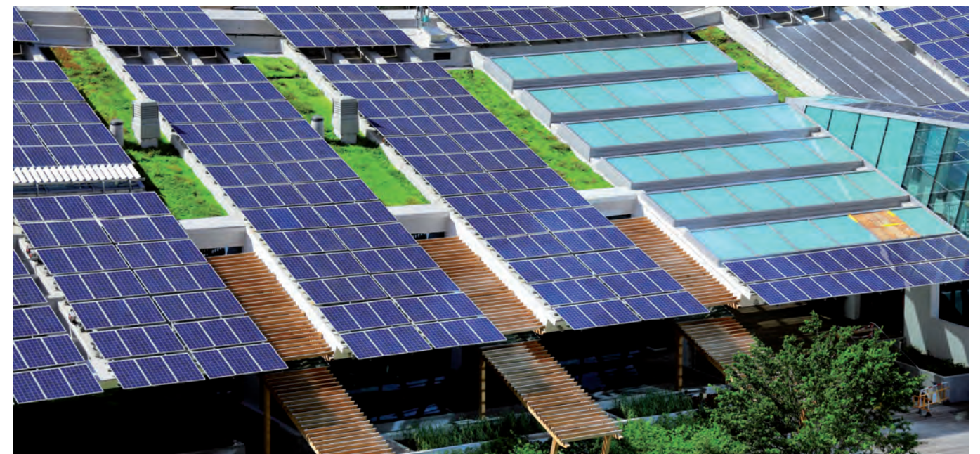
Copertura con pannelli fotovoltaici
