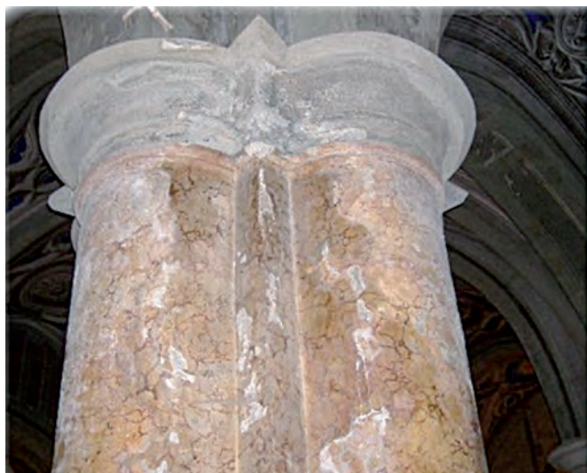
Umidità di risalita ed efflorescenze saline sulle colonne di una chiesa. Fonte: Biodry Wall & Wall. In questa foto si nota come l'umidità di risalita abbia raggiunto una altezza di quasi 3 metri e saturato le colonne di sali causando crepe e distacchi dell'intonaco e del rivestimento.
