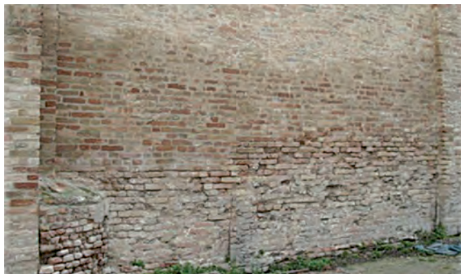
Umidità di risalita in facciata con mattoni a vista. Fonte: Biodry Wall & Wall
