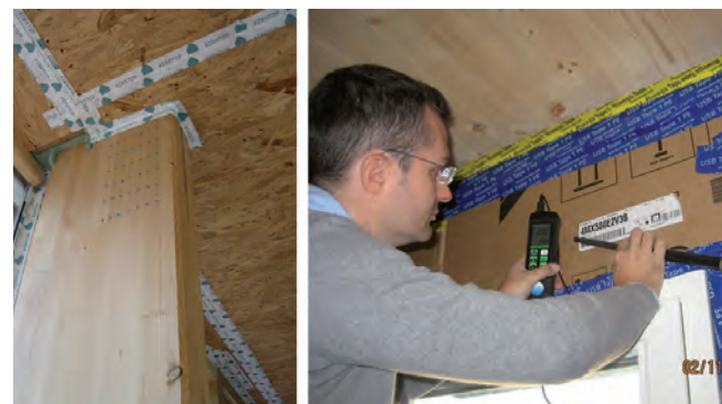
Nastrature negli edifici in legno. Esecutore del BDT ing. Andrea Cagni.
